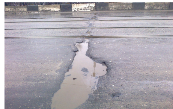
Рис. 1. Типичная деформация на покрытии моста
